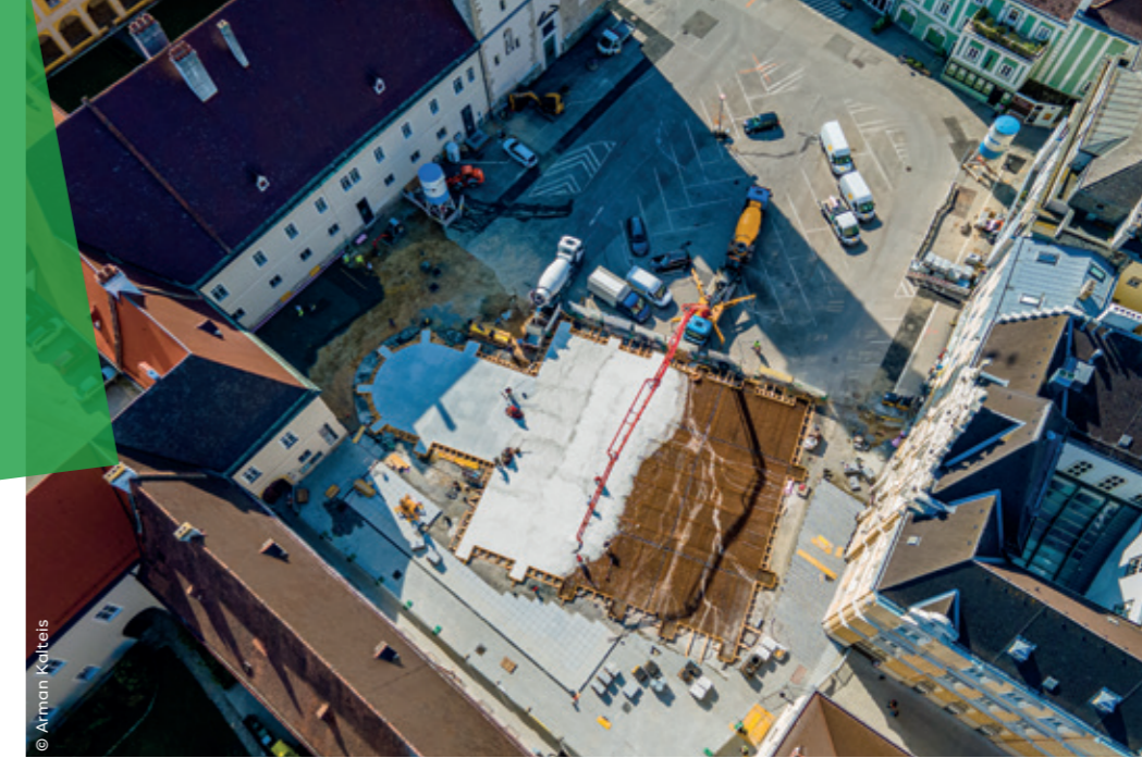
PLATZ IN PROGRESS: WEISSER BETON MACHT DIE EINSTIGE GOTISCHE KIRCHE AM DOMPLATZ IN IHREN UMRISSEN SICHTBAR.
